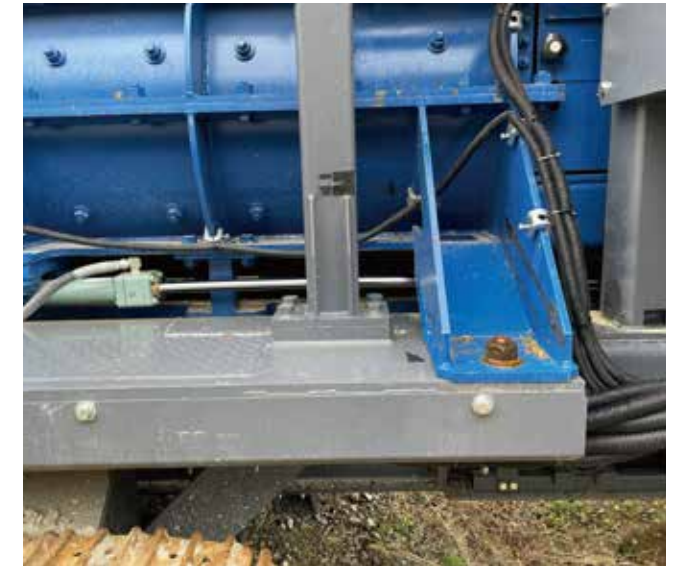
油圧シリンダによるゲート開閉
